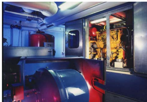
Blockheizkraftwerk im Dienstleistungskomplex „Königstadt-Terrassen“ in Berlin: Die Mieter beziehen preiswerten und umweltfreundlichen Strom der Berliner Energieagentur; die Gebäudeeigentümer sind von allen Risiken der Energieversorgung entlastet.
